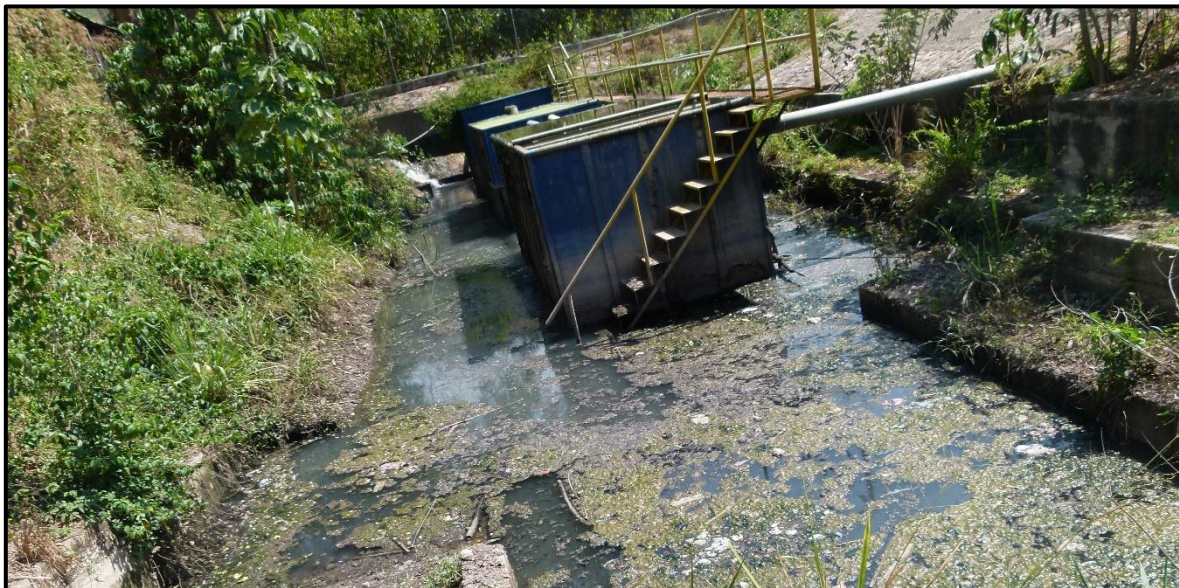
Fotografía No 19 Rebose Planta de tratamiento de aguas residuales del corregimiento de Betania
