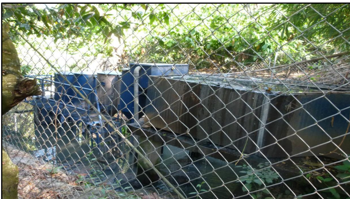
Fotografía No 20 Rebose Planta de tratamiento de aguas residuales del corregimiento de San José de oriente.
